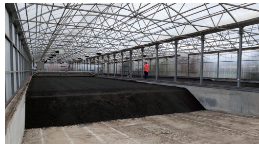
Serre de séchage des boues de la station d'épuration de Gunstett (67)
